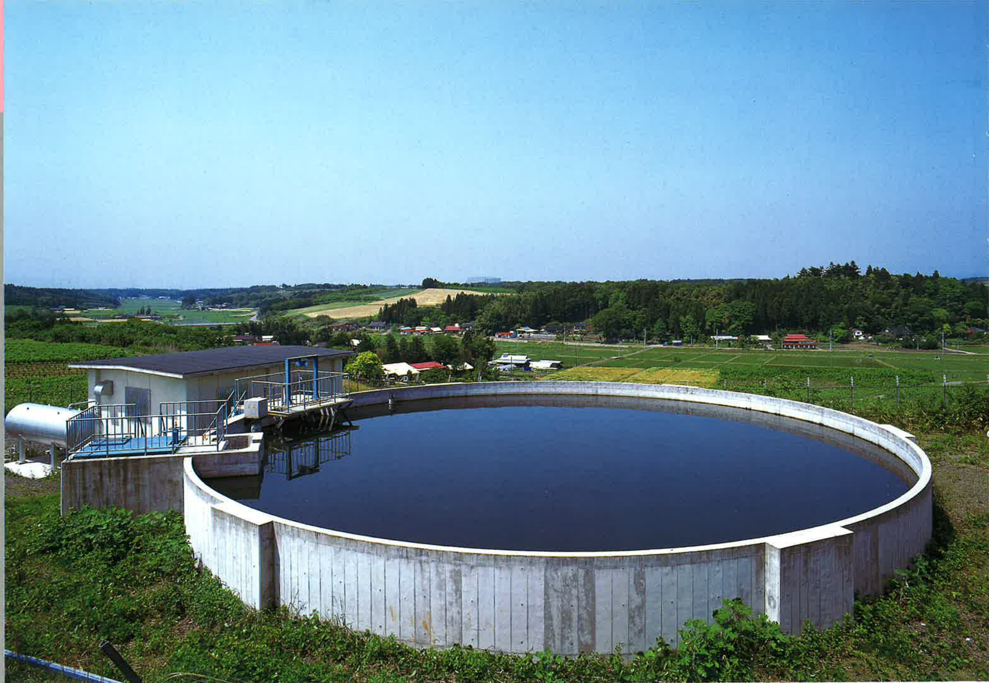
7号ファームポンド・加圧機場
